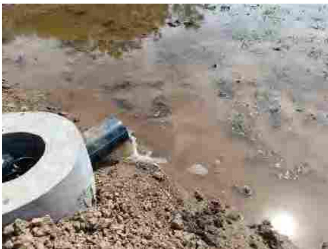
废水治理设施照片
